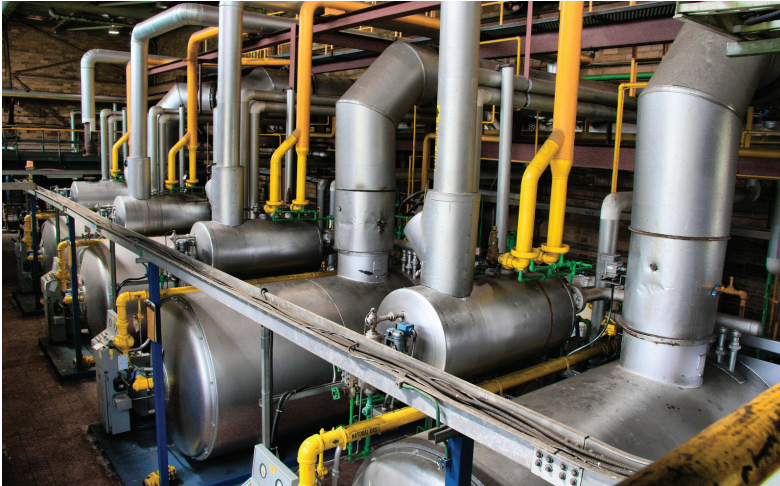
应用实例：锅炉厂房
